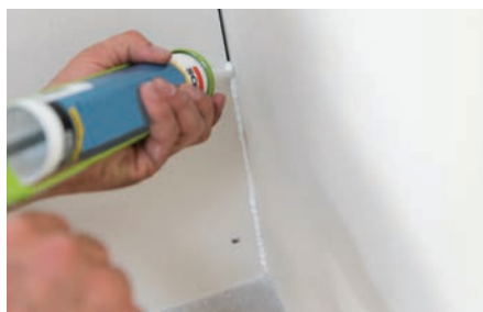
Traitement des angles et points singuliers à l'aide d'un mastic sanitaire label SNJF
